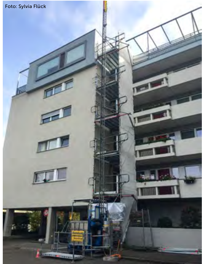
Dieser temporäre Aussenlift war während der Liftrenovation an der Regulastrasse 23 und 25 in Betrieb.
