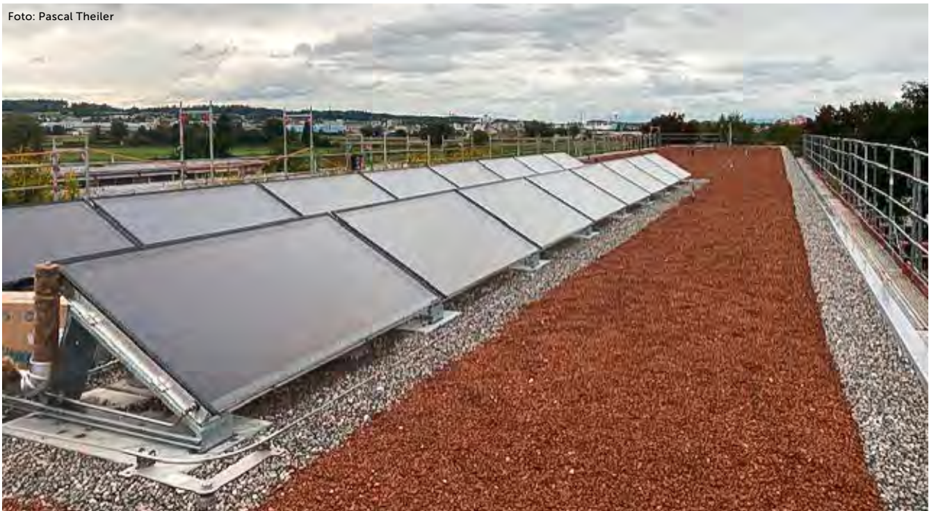
Die neue Solaranlage auf dem Dach der BGW-Siedlung in Dällikon.
